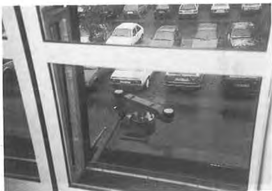
写真－５ Hバーン振れ止め装置
