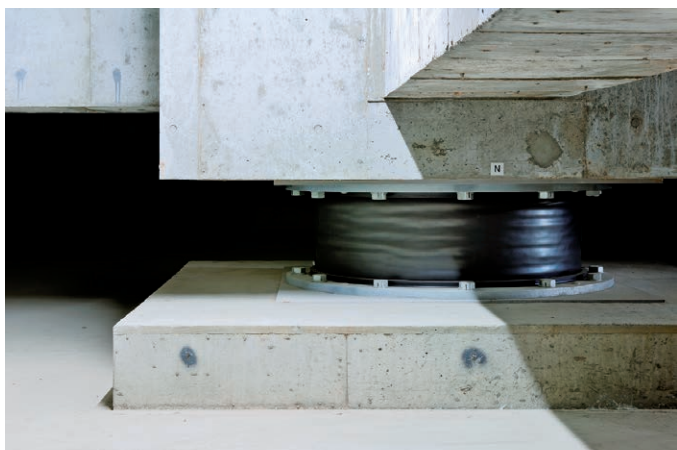
写真－2 免震装置
