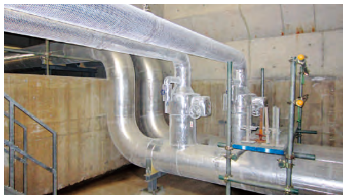
写真－2 ピット内エネルギーネットワーク（熱供給導管）
