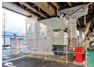
写真-2 非常用発電機 止水板
